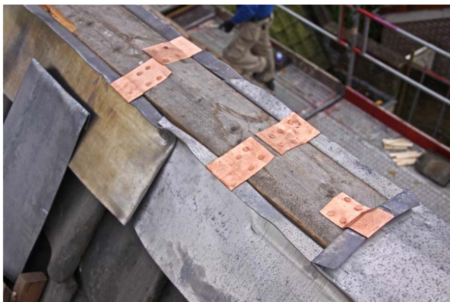
Figuur 1: Loodzwaarte voor toepassing bij aansluitingen. Noklood aangebracht in 3 delen van 25 kg/m 2 , vastgezet met koperen klangen. De delen zijn in lengtes van 1.0 meter aan elkaar gefelst.
